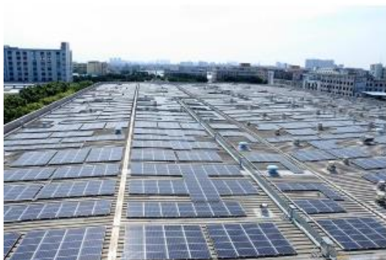
分布式光伏电站(2.45 MWp)
